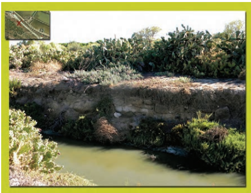
Figura 15. – Paramento Este de la calzada. El agua del caño de las salinas ha desprendido la tierra, dejando al descubierto la estructura. En el recuadro, su situación; enfrente, un toruño.
